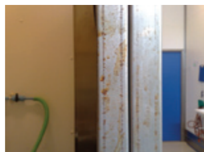
Afbeelding 9. (links) RVS 316-deurstijl aangetast door zoutzuurdampen.
